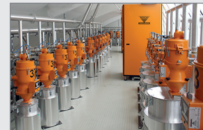
Il sistema centralizzato di deumidificazione dei materiali con un totale di tre deumidificatori ad aria secca del tipo CKT presso Procter & Gamble Manufacturing GmbH 38 tramogge di deumidificazione con un volume di aria secca fino a 1600 m 3 /h
